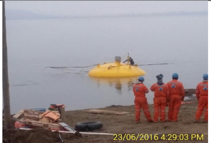
Tapón en su posición original. Se aprecian los cables hacia la retroexcavadora y hacia los teclés en la Balsa de Trabajo, usados en las maniobras de enderezamiento.
